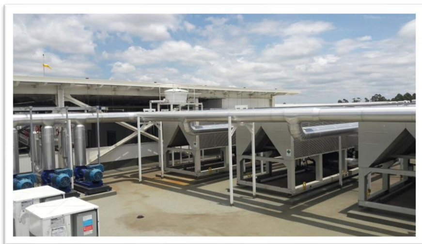
Imagem: Compressores e Chillers do Centro de Convenções
